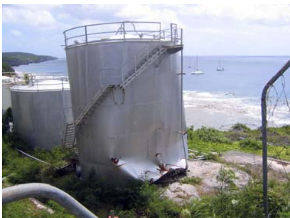
Durch mehr als 25 Meter hohe Wellen vom Fundament verschobene und eingedrückte Kraftstofftanks oberhalb der Pier in Alofi. Im Hintergrund der Ankerplatz
