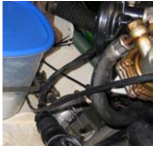
Mit Motorraumkontrolle, vor allem der Stopfbüchse
