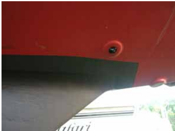
Den leckenden vordersten Kielbolzen versuchen wir durch eine neue Füllung der Gumminahnt zwischen Kiel und Rumpf zu überlisten.
