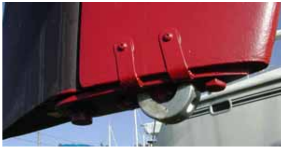
Elektrolyse an der Ruderplattenaufhängung – da half nur ein Komplettumbau und eine zusätzliche Verbolzung an der Skegseite – die Zinkanode soll nun verhindern dass uns eines Tages das Ruder in die Tiefe fällt!
